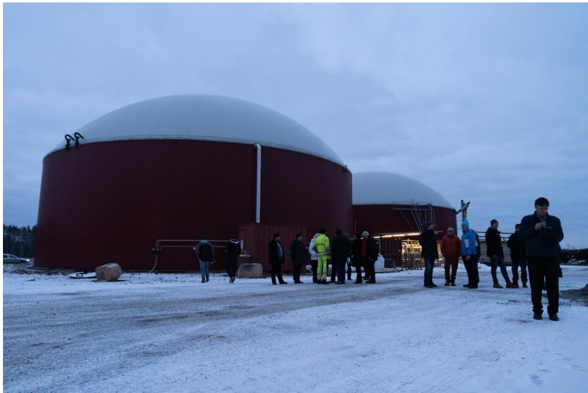
Biokaasulaitoksessa kaksi 5 000 m 3 reaktoria, joista kuvan etumainen toinen toimii jälkikaasureaktorina
